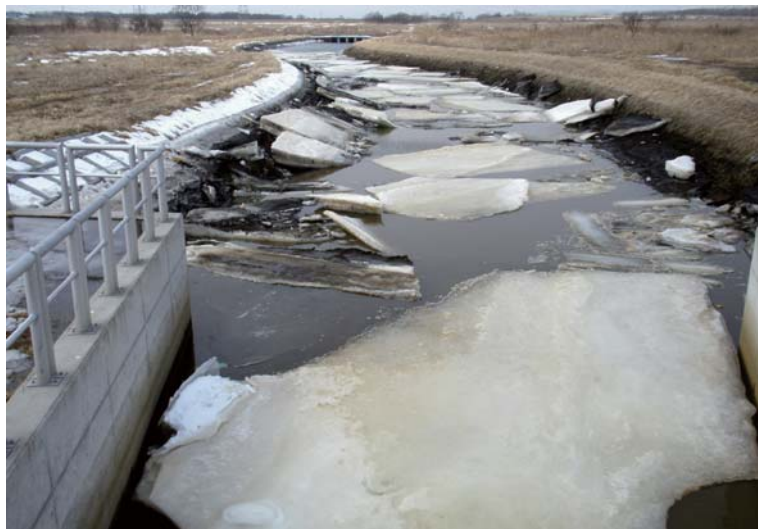
写真-3.10: 新釧路川 K2 樋門 (KP.4.50 L) における氷板痕跡
