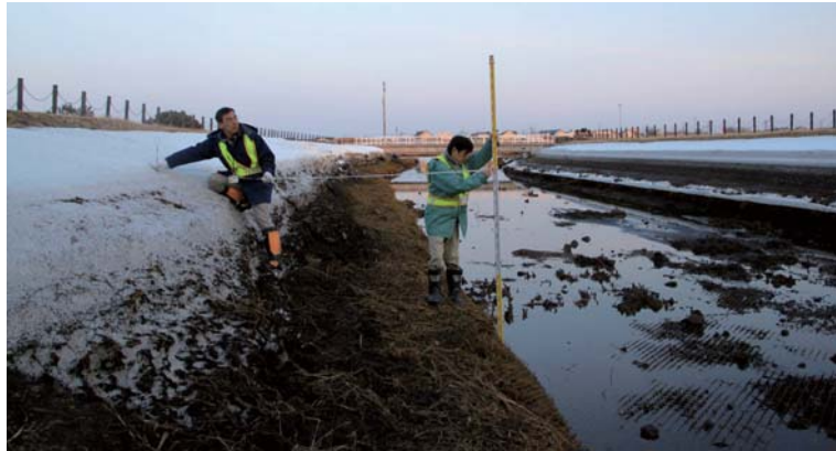
写真-3.9: 新釧路川 K1 樋門 (KP.2.80 R) における浸水痕跡
