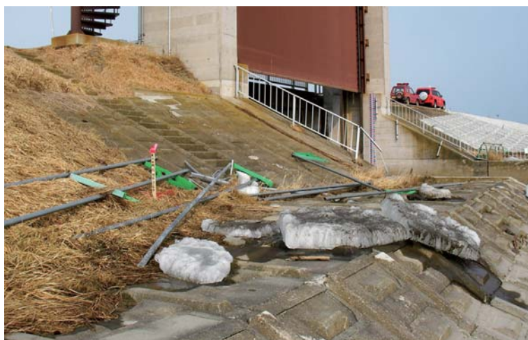
写真-3.6: 浦幌十勝川 U1 水門における津波痕跡 (KP.1.10L)
