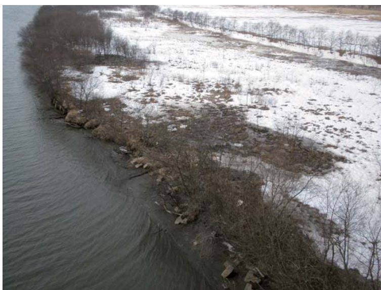
写真-3.5: 十勝川 T2 橋梁より撮影した高水敷の冠水状況 (KP.5.72L)
