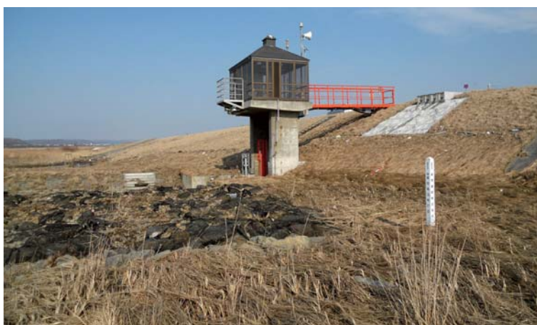
写真-3.15: 沙流川 S1 樋門における痕跡（KP.0.40 L）
