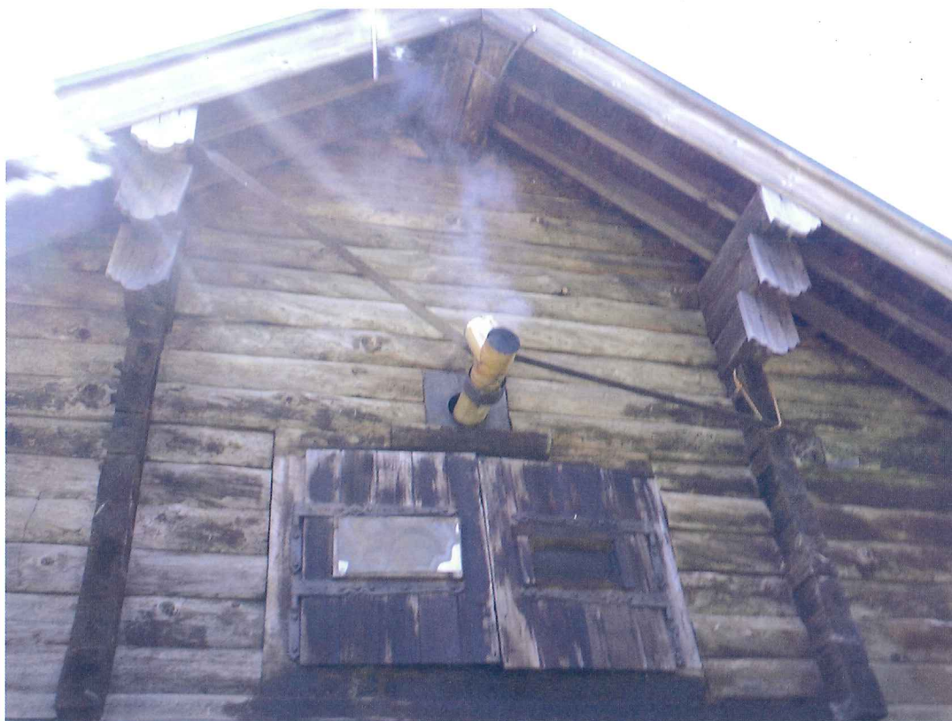
老朽化が進む空沼小屋、早急に修理が望まれる。
