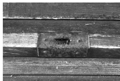
写真2. 11号ケース下部の外扉受け
