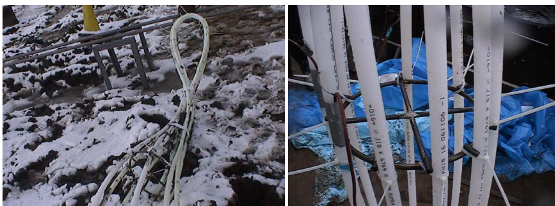
写真 4-3 細径多数本管(材質：架橋ポリエチレン管)
