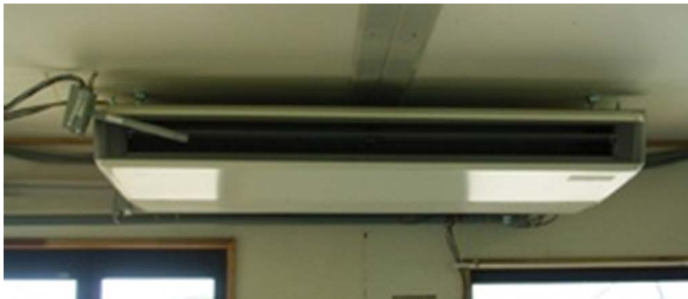
写真 3-3 ビルマルチ室内機(2008 年度使用)
