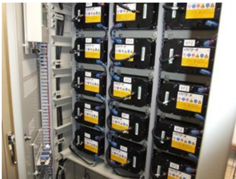
図 2.10 帯広市 MG に建設された蓄電池システムの外観
