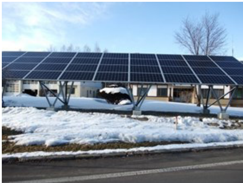
図 2.9 帯広市 MG に建設された PV システム
