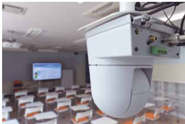
図 2-25 カメラは S9 編集室の機器卓で制御
