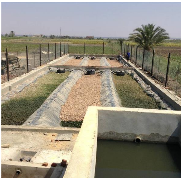
Fig. IV-7 完成した集落排水施設（嫌気性槽から礫床・植生浄化槽を望む） （在エジプト日本大使館提供）
