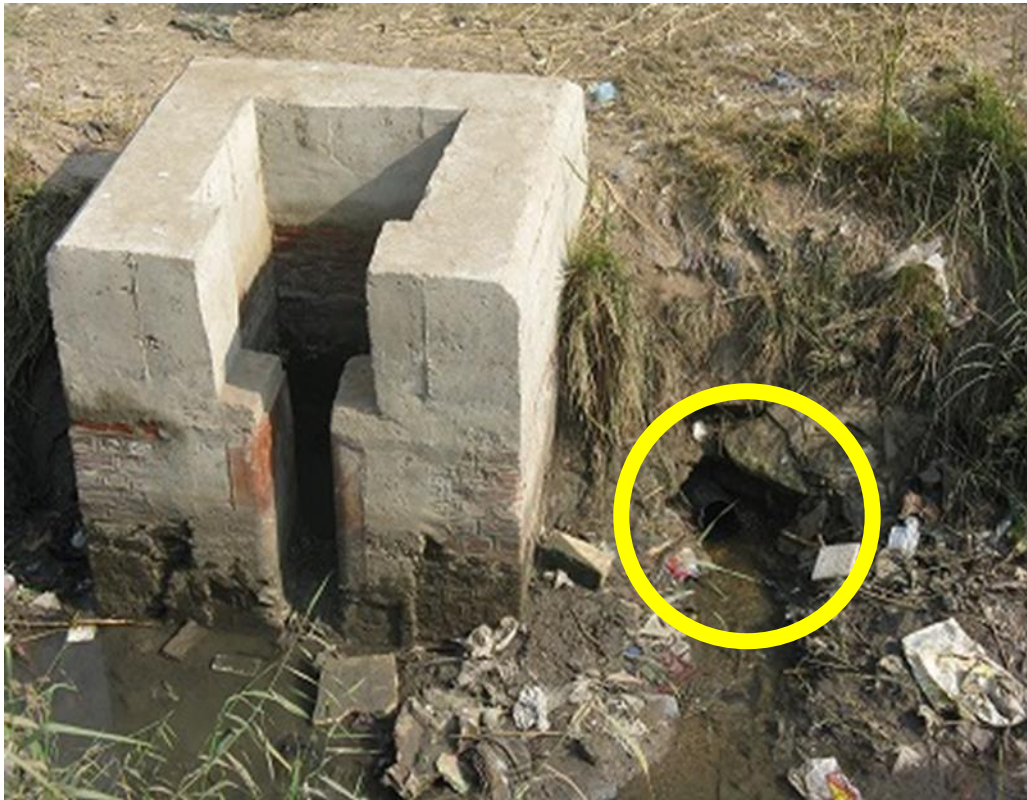
Fig. III-3 違法取水の事例（シノーリス地区） Illegal intake of irrigation water at Sinnoris pilot site
