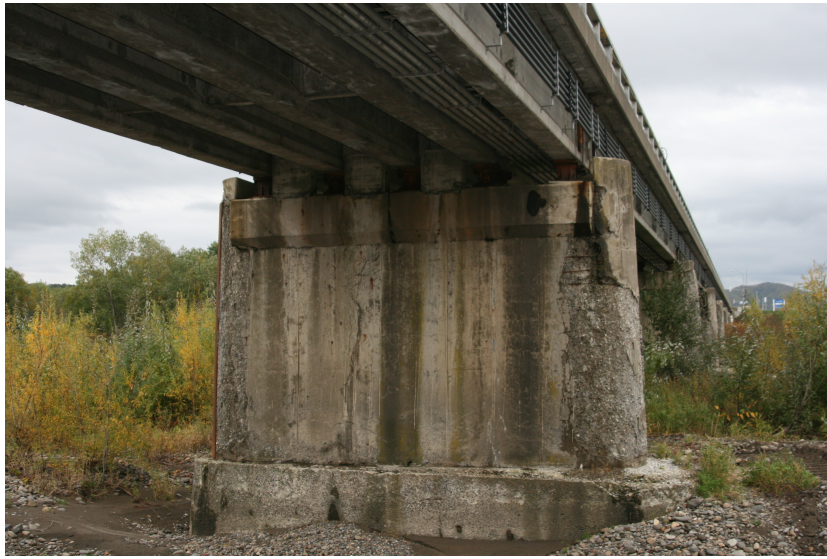
図-1.1 凍結融解作用により著しい損傷を生じた橋梁
