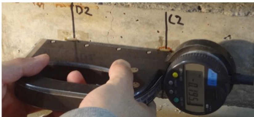
図-2.25 コンタクトストレインゲージによるひび割れ幅の測定
