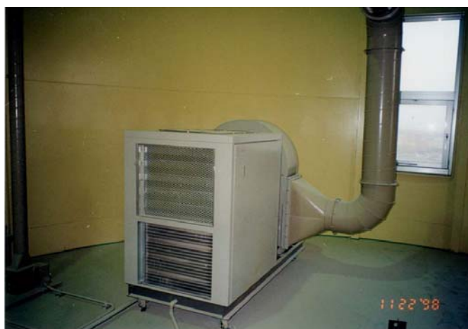
写真2 サイロ内空間自動換気装置
