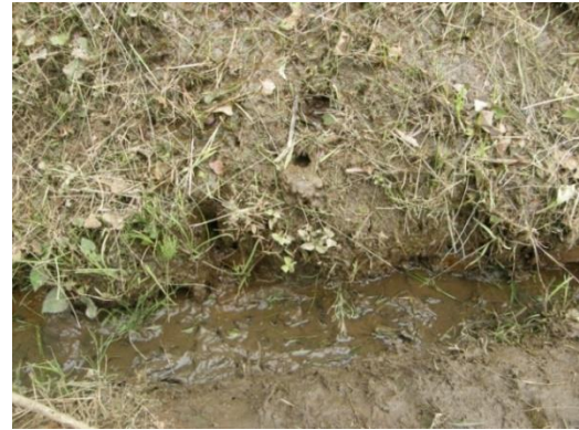
図 3.3i 側溝には泥が 12cm～28cm ほど堆積している。側溝上部の巣穴開口部と巣穴を掘った際に押し出した堆積物が確認できる。
