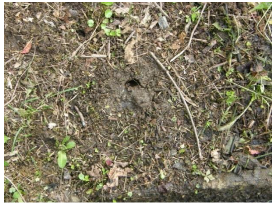
図 3.3n コンクリート側溝上部の巣穴開口部と 巣穴を掘った際に押し出した堆積物 (田中一典撮影)
