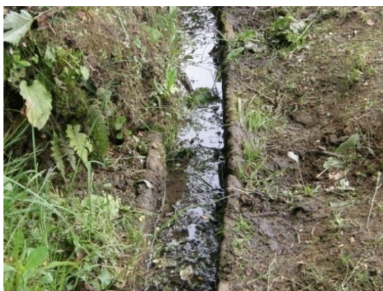
図 3.3f 側溝には泥が 6cm～7cm ほど堆積している (田中一典撮影)
