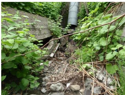
図 3.12a 崩れかけているコンクリートブロック護岸と生息場所上部 （田中一典撮影）
