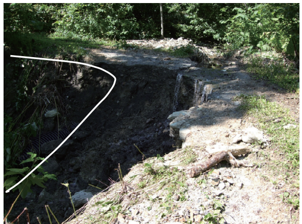
写真 10. 横断管吐口の侵食による路肩崩れ（通行支障）
