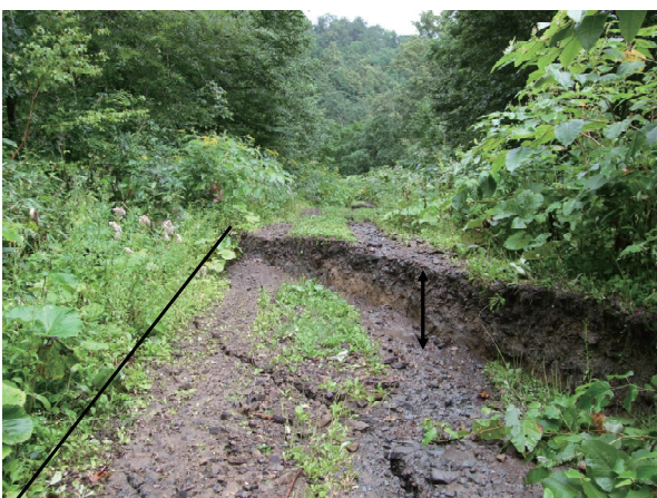
写真3. 陥没（通行不能）
