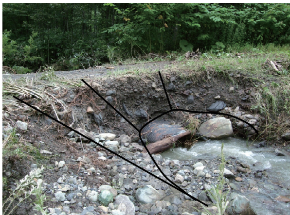
写真 9. 横断管飲口の侵食による路肩崩れ（通行支障）
