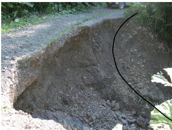
写真1. 法面浸食による林道崩壊（通行不能） （写真中の線は元の林道の位置を示す。）
