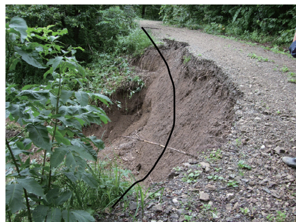
写真4. 法面浸食による路肩崩れ（通行支障）
