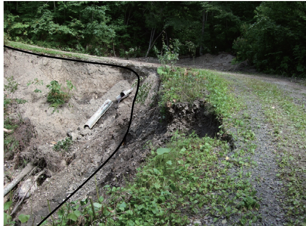
写真 8. 横断管吐口の浸食による林道崩壊（通行不能）
