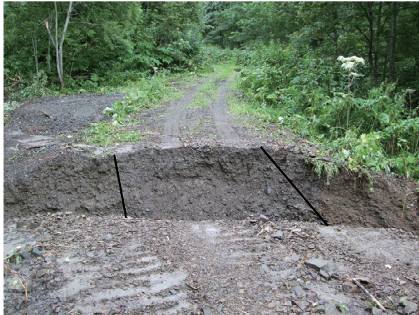
写真 7. 横断管流出による林道寸断（通行不能）
