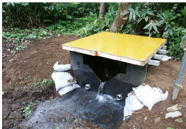
図-7 設置後の量水堰
