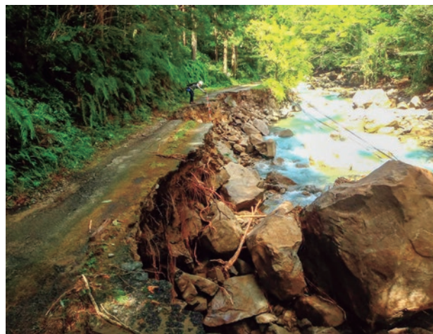
路肩が崩壊した国道。8月28日撮影（写真提供：和歌山研究林）
