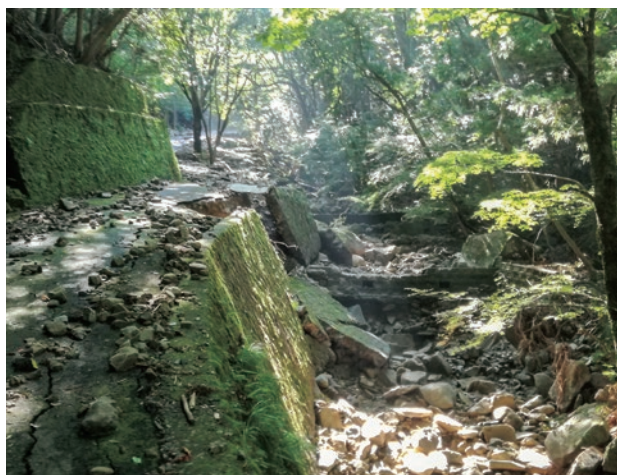
路肩と護岸が崩壊した林道。8月28日撮影（写真提供：和歌山研究林）
