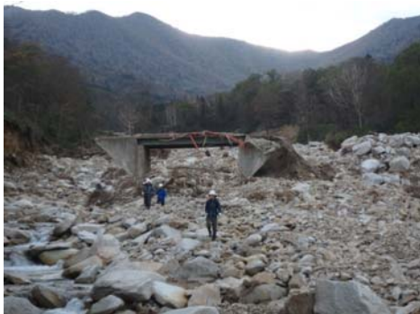
ペケレベツ川河道内の侵食および石礫等堆積状況 (旧日勝スキー場付近 横断橋 )
