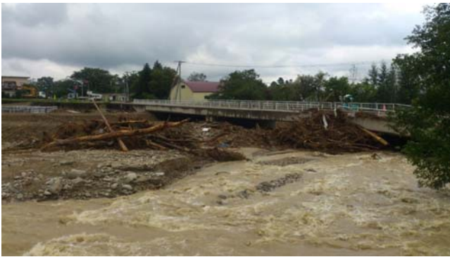
清水町市街地ベケレベツ橋(道道)での流木・土砂による閉塞状況
