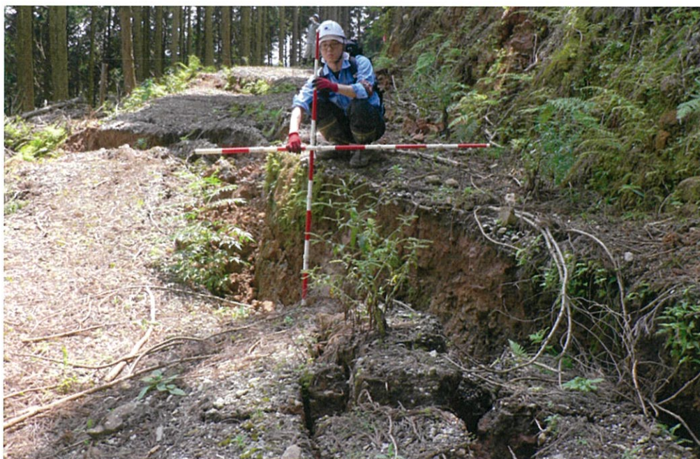
図－4.7 滑落崖の上部面に生じた亀裂
