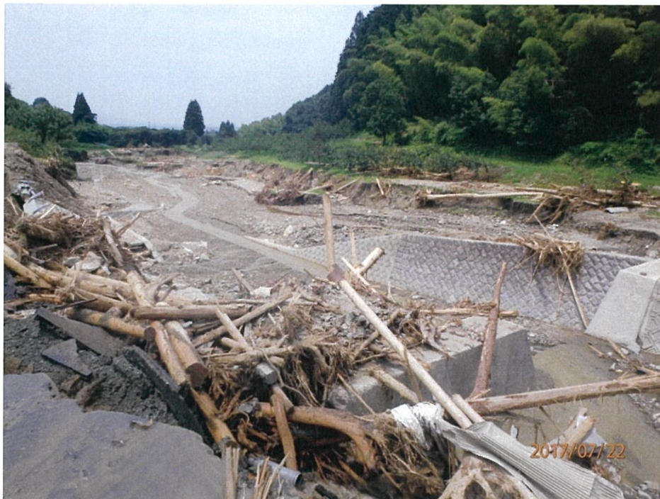
写真－3.4 奈良ヶ谷川・ため池上流区間における河岸洗掘状況（写真奥が下流）
