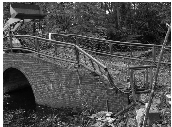
図 2. 植物園内めがね橋の被害状況
