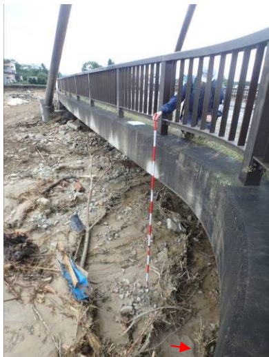
写真10 石山橋での土砂・流木の堆積状況
