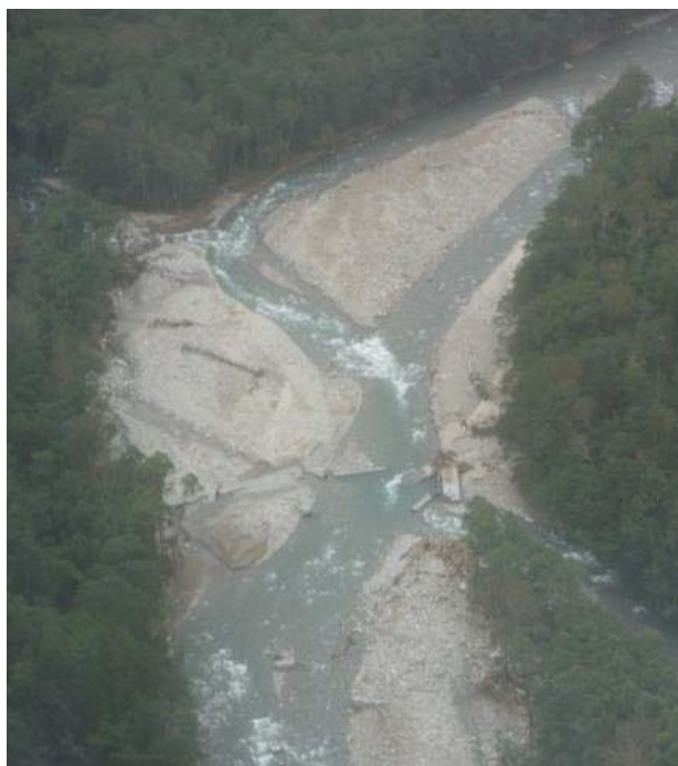
写真 1-5. 破壊されたオピリネップ沢直下の治山堰堤
