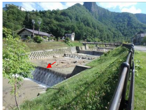
写真9 砂防堰堤下流の溪流保全工
