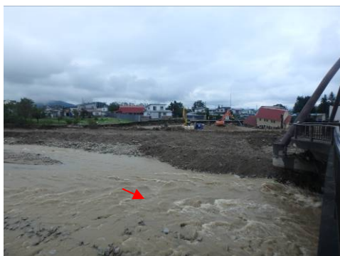
写真12 石山橋上流での左岸側の側岸侵食
