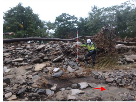
写真１５ 九号川上流部の土砂堆積状況
