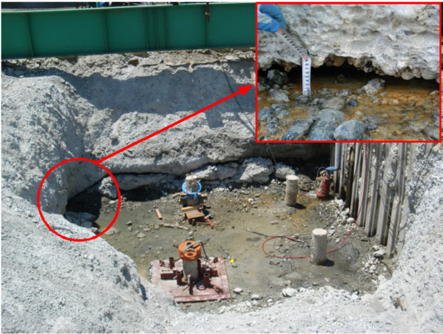
図-13 基礎版下の空洞の様子
