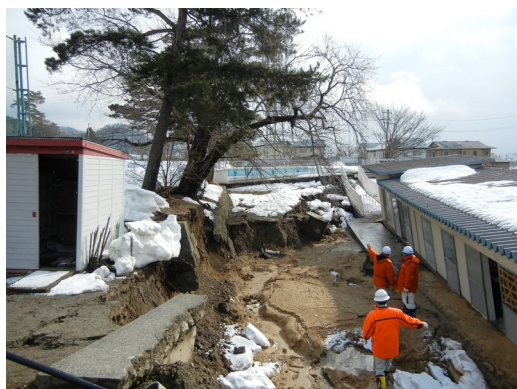
写真 1 一箕中学校周辺の被災状況
