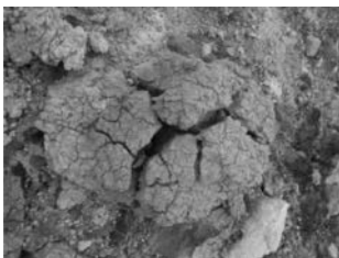
写真-5 土塊の乾燥収縮によるひび割れ(2016年7月24日撮影)
