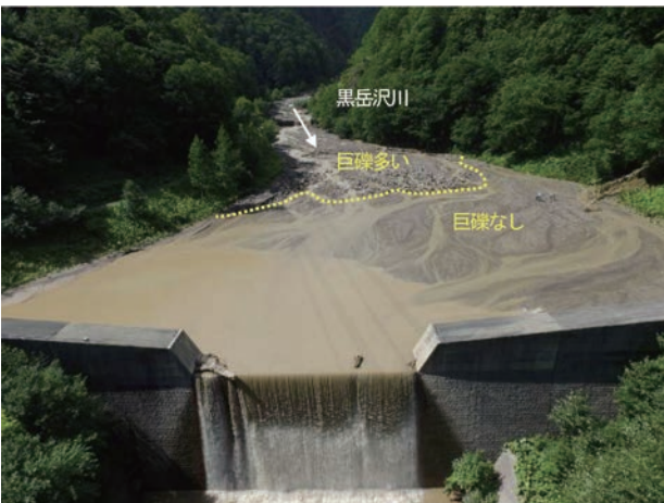
写真-4 黒岳沢川第 1 号えん堤の状況 (8/24 撮影) Photo 4 The Kurodakesawagawa No. 1 sabo dam
