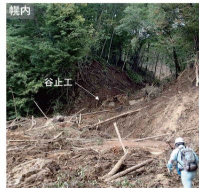
図-11 谷出口の土砂氾濫、地形、谷止工(幌内地区)
