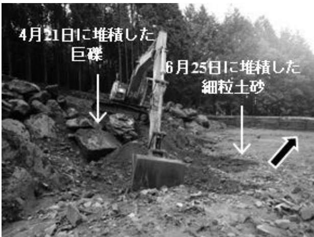
写真-9 上の小屋川 3 での 2016 年 6 月 25 日発生土石流の除石状況（若宮誠二氏撮影）
