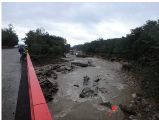
写真-9 溪流保全工下流の側岸侵食
