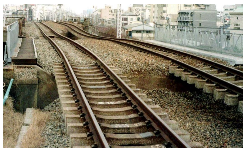
図 1.2 兵庫県南部地震（1995）での被災事例 5) (構造物の破壊による軌道被害)
