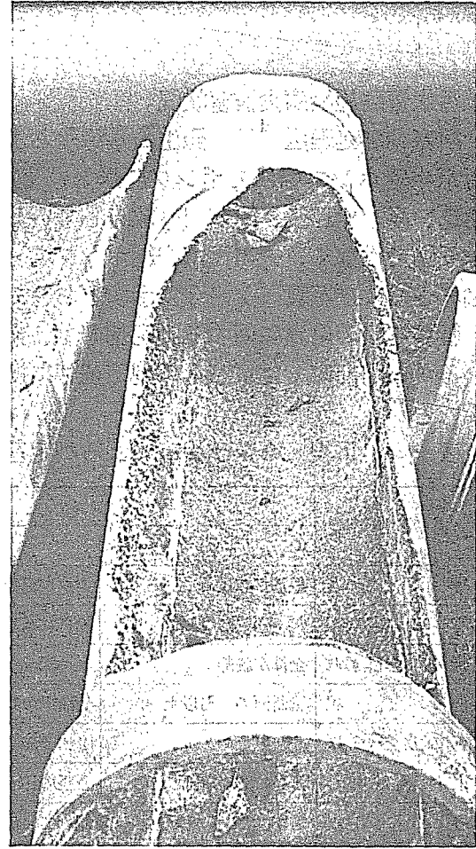
写真-2 污水管路の腐食状況
