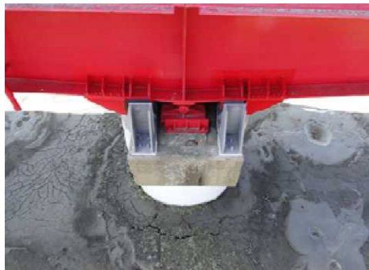
b) 橋脚周りの噴砂状況
