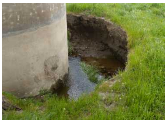
a) 確認された橋脚の移動の痕跡
