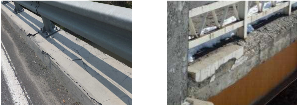
図-1.3.1 橋梁地覆の断面修復箇所の再劣化事例 2)
