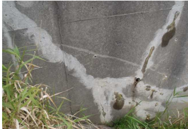
図-1.3.6 ひび割れ注入による補修後の不具合再発事例 2 9)
