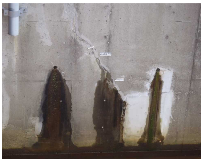
図-1.3.5 ひび割れ注入による補修後の不具合再発事例 1
