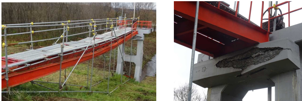
図-1.3.3 再劣化による樋門の管理橋の傾倒事例
