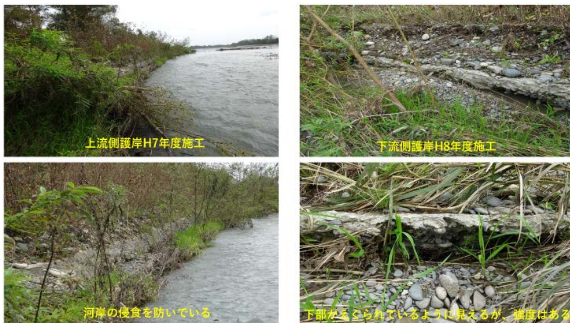
図 6-7 2016 年 8 月洪水後のコンクリートウォールを用いた侵食防護工周辺の様子 (紅葉流域設計・紅葉克也氏提供)
