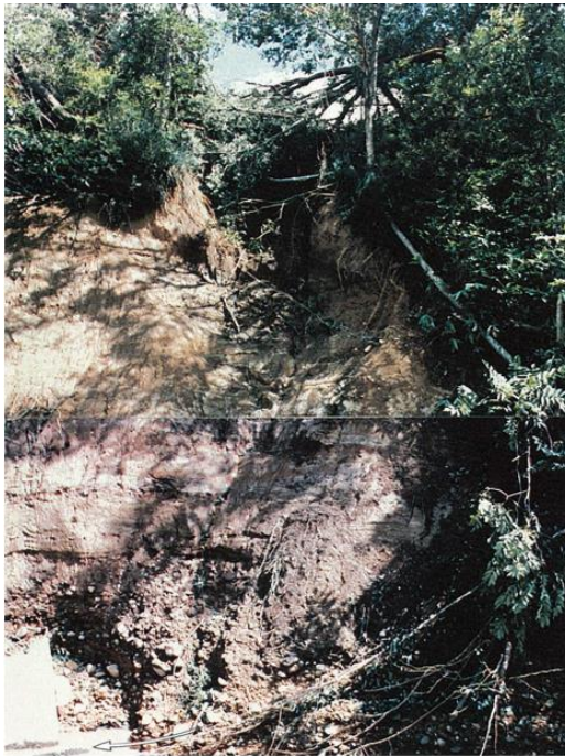
(a)豊平川支川オカバルシ川河岸の崩壊状況
