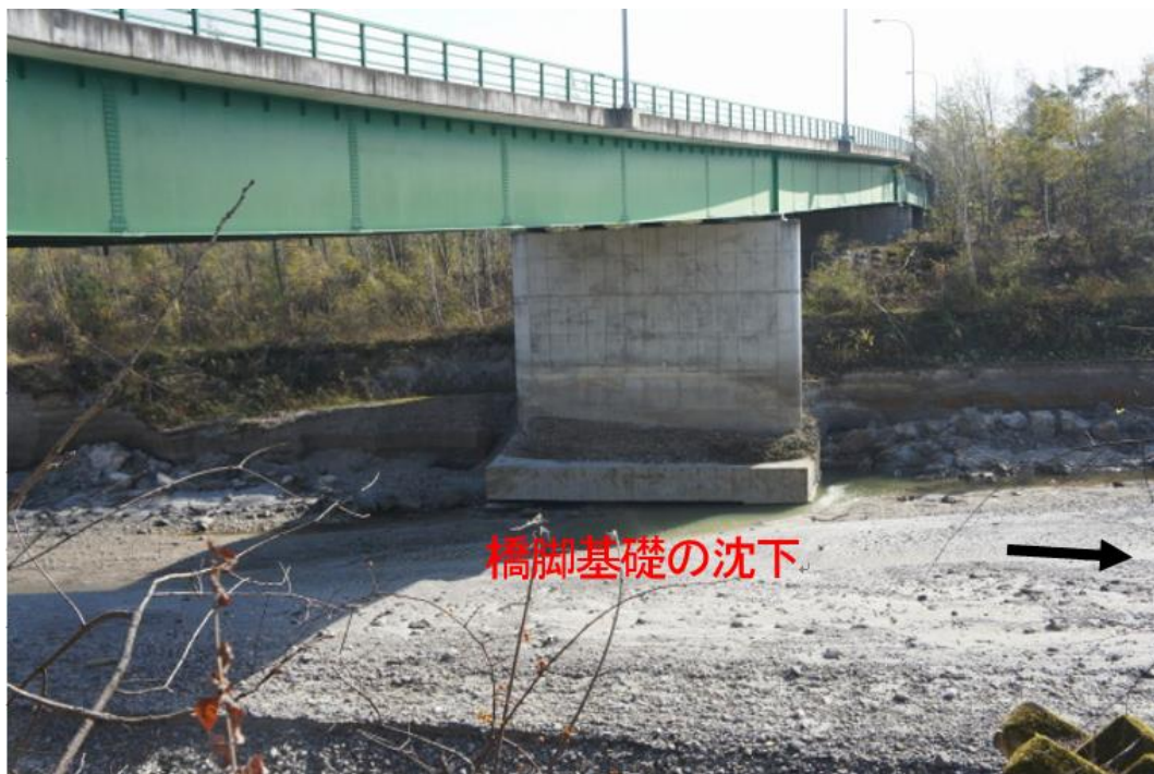
図 4.3 2016年8月北海道豪雨災害における然別川 風雲橋の橋梁の被災状況
