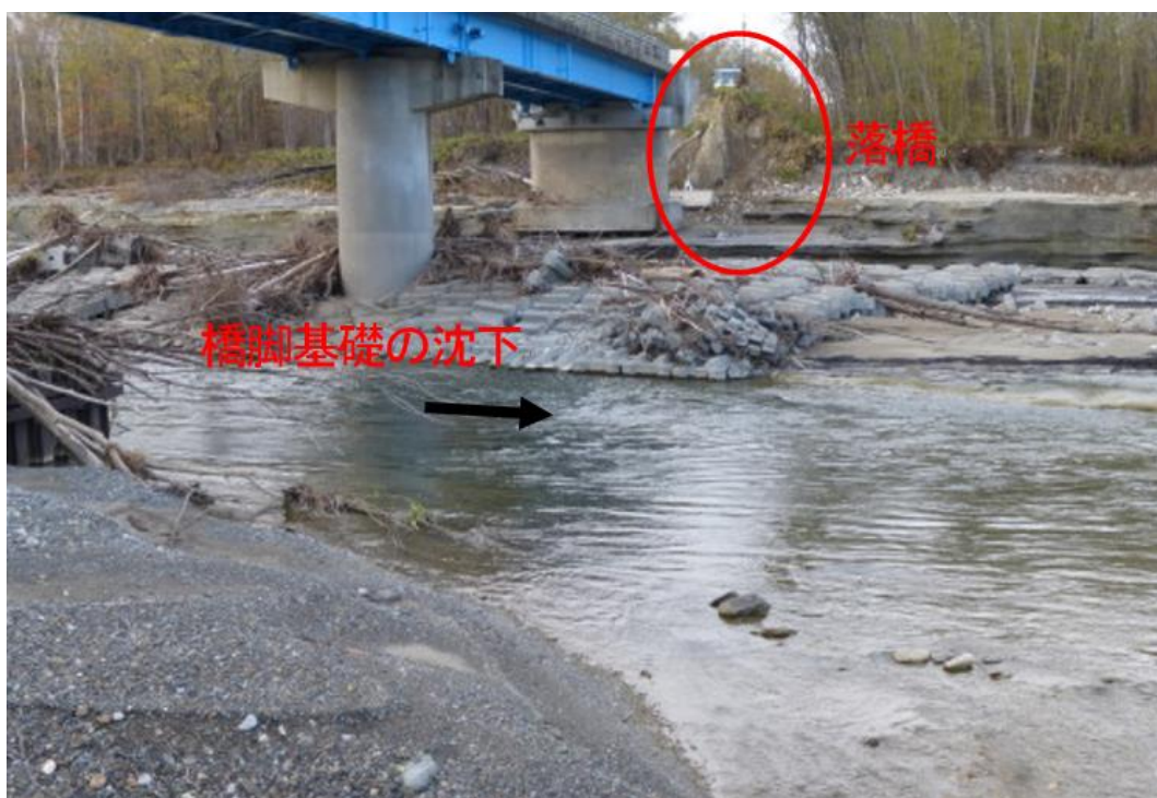
図 4.2 2016年8月北海道豪雨災害における戸蔭別川 戸蔭大橋の橋梁の被災状況
