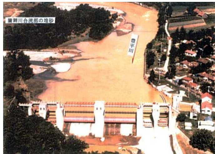
(a) 藻岩取水堰の堆砂状況
