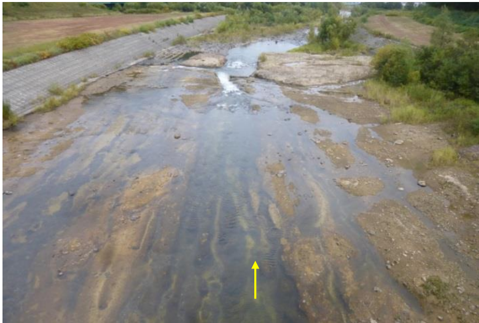
(b) 五輪大橋直下流部の露岩状況 (KP21.5 付近)
