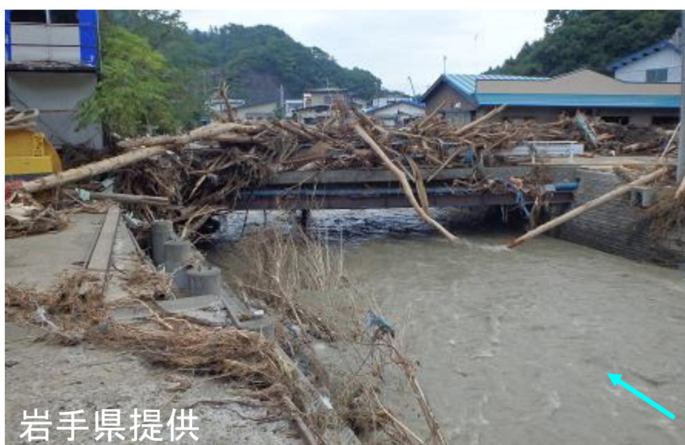
図 5.2 2016年8月東北豪雨における橋梁の流木被害状況
