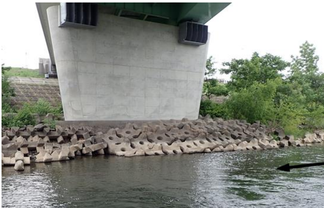
図 4.1 豊平川新藻岩橋の橋脚基礎が露出している状況（2018年）
