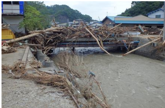
(b) 流木による橋梁被害
