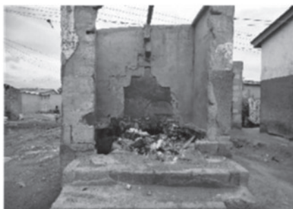
壊れたコンポスト・トイレ
