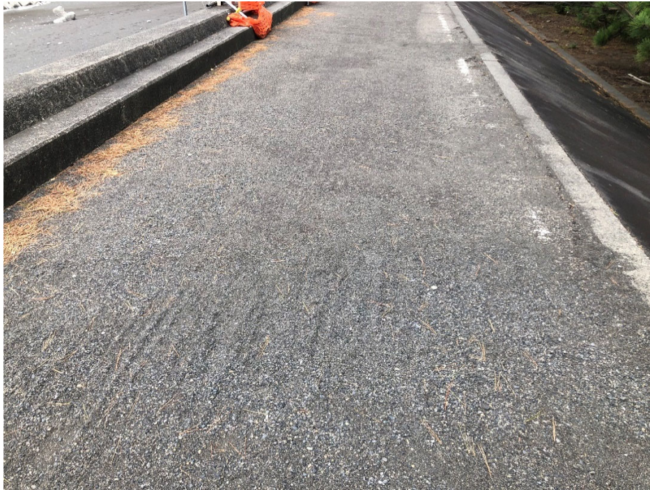
図 4.6 台風通過後の堤防天端状況
