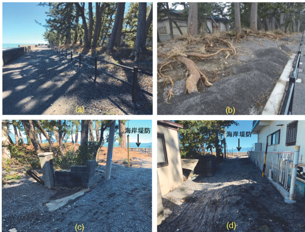
図 3.6 台風来襲直後の 2019 年 10 月 13 日の堤防越波状況, 藤原 (2020)
