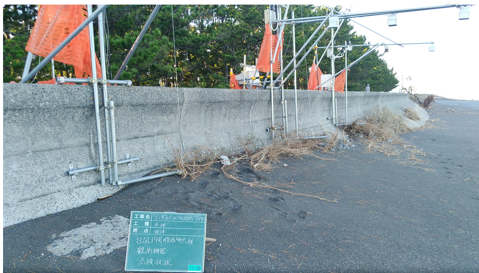
図 4.2 台風後の海岸状況
