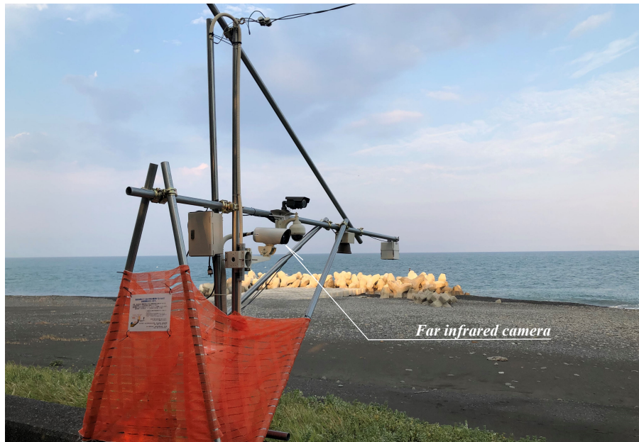
図 2.6 遠赤外線カメラの設置状況
