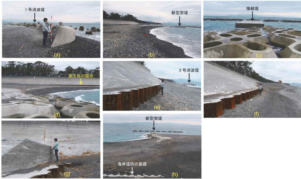
図 3.7 2019 年 12 月 19 日の侵食状況, 藤原 (2020)
