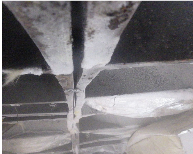
図 3-15 セグメント目開き, 主桁座屈の発生状況
