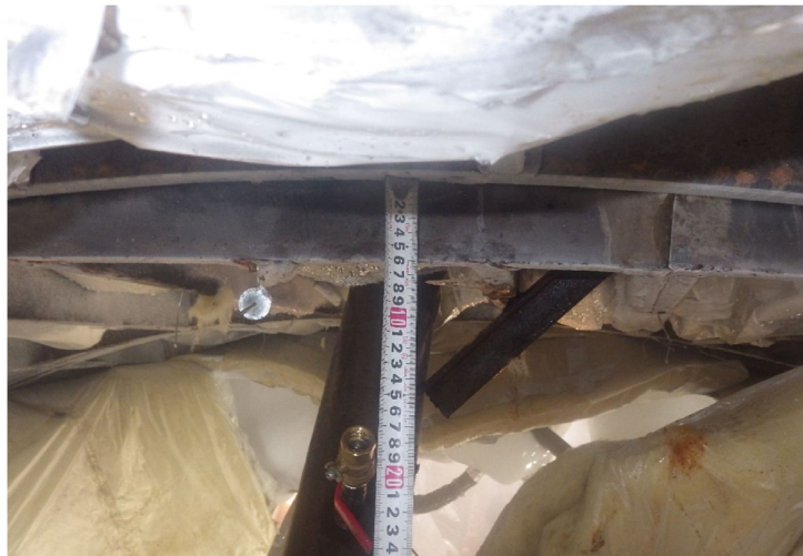
図 3-14 セグメントの目違い発生状況
