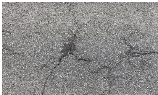
(a) ひび割れ
