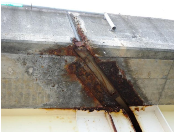
(c) 掛け違い部の壁高欄の隙間
