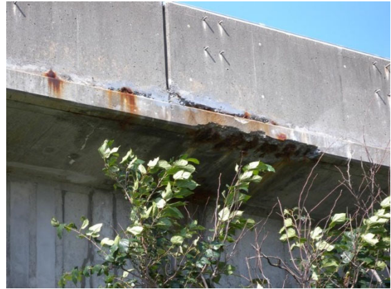
(b) 壁高欄の隙間
