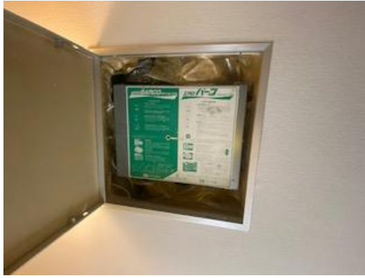
(i) 故障システム本体（交換前）
