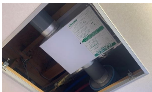
(i) 故障換気システム本体（交換前）
