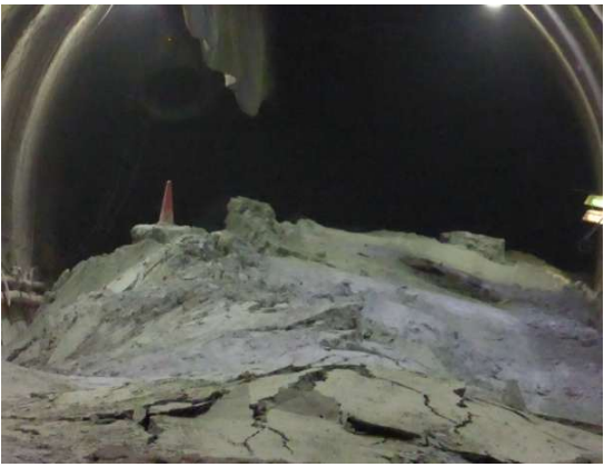
写真-1.3.2 インバートの変状
