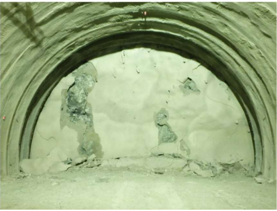
写真-1.3.1 切羽の押出し
