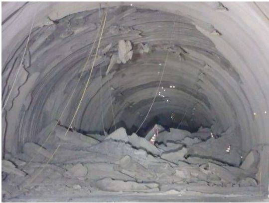
写真-1.3.3 天端および側壁の変状
