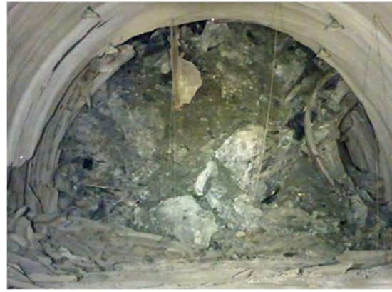
写真-1.3.4 天端崩落
