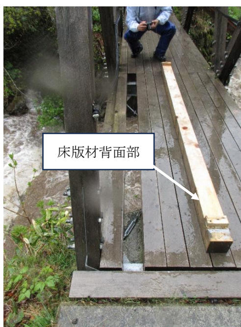
(b) 床版部材背面
