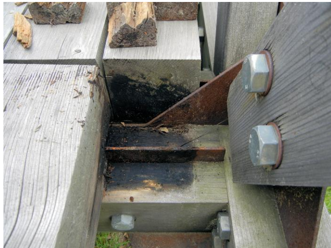
写真 3-8 横梁上面の変色箇所
