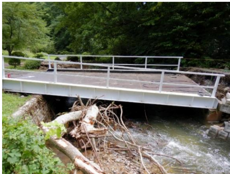
写真 1-3 令和 4 年（2022 年）8 月豪雨による橋梁被害（北海道函館市）
